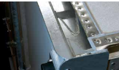
Montage extérieur des rivets du toit
